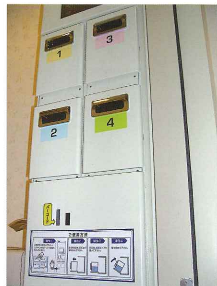
4 床室トイレ内の 採尿自動検査装置
